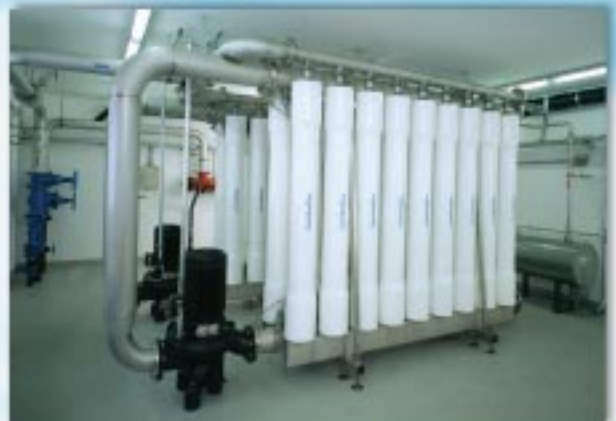
Installation d'ultrafiltration 2'200m 3 /jour
