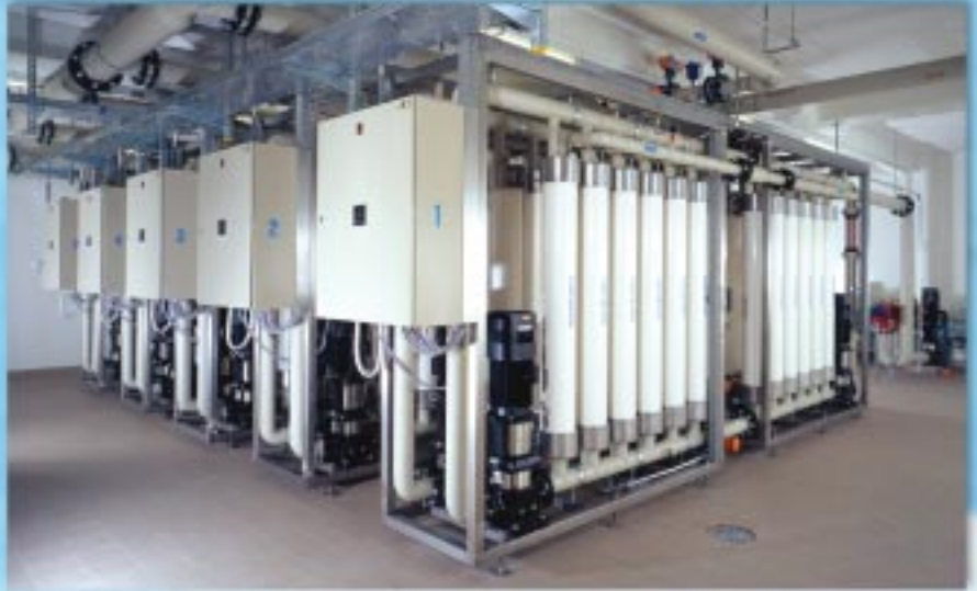
Installation d'ultrafiltration 10'000m 3 /jour
