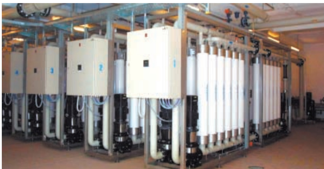
Ce sont deux installations de ce type qui seront bientôt mises en service sur l'île de Moorea.
