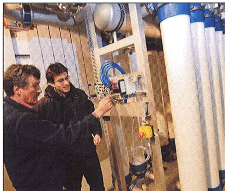
Roland Dussex, exploitant de la nouvelle station de filtrage réalisée par Membratec à Anzère et Jean-Julien Dessimoz, ingénieur en environnement de la société sierroise. BITTEL
