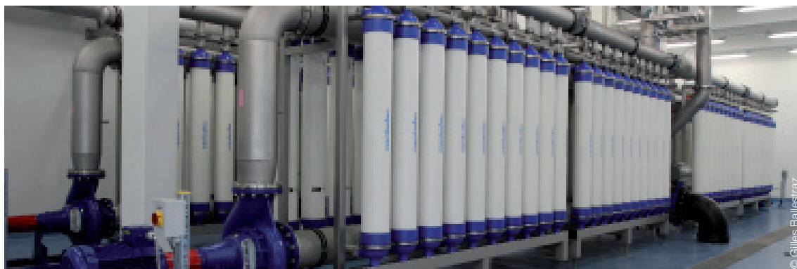
Pour les Communes de Conthey, d'Ardon et de Vétroz, Membratec a installé une usine d'ultrafiltration, d'une capacité de 500 m 3 /h, pour le traitement de leurs sources karstiques.
