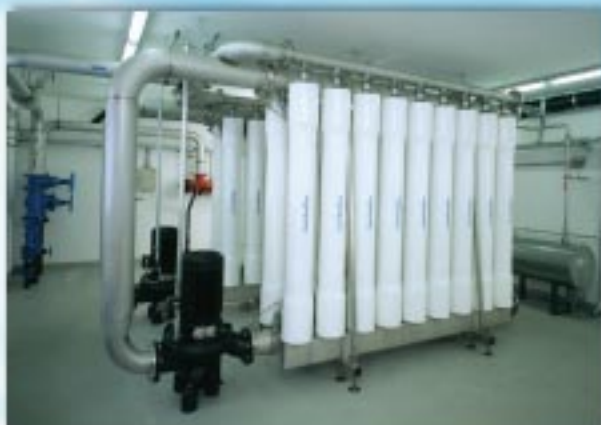
Installation d'ultrafiltration 2'200m 3 /jour
