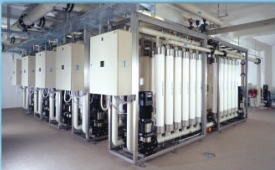
Installation d'ultrafiltration 10'000m 3 /jour
