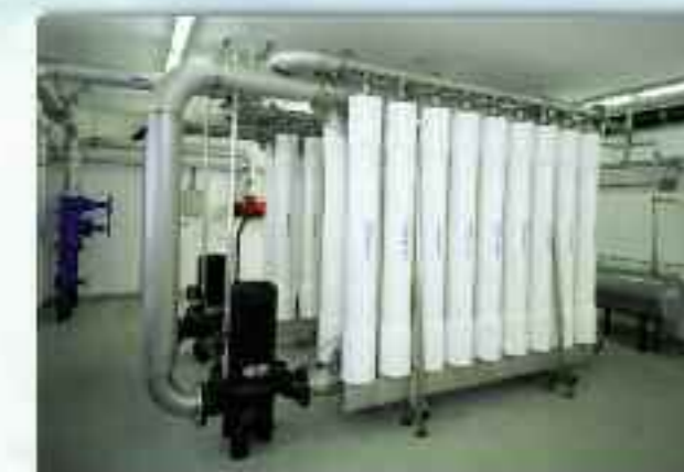
Installation d'ultrafiltration 2'200m 3 /jour
