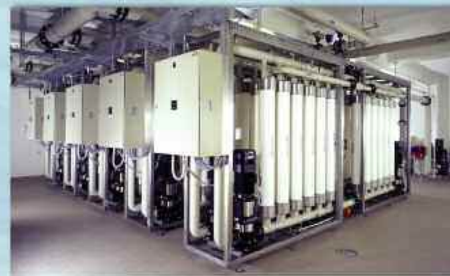
Installation d'ultrafiltration 10'000m 3 /jour
